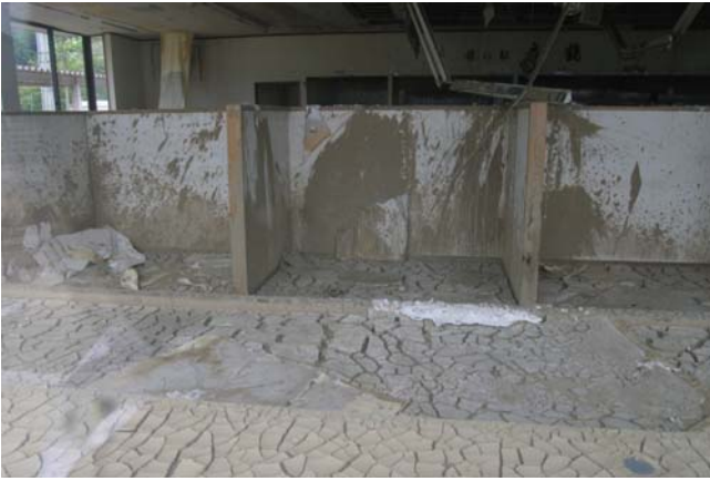
図-4 洪水の被害を受けた建造物(大江町)
