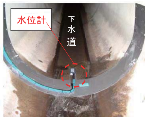
新たな観測：下水道管内水位観測の例
