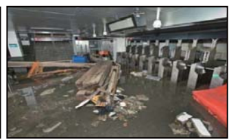
平成24年10月 ハリケーン・サンディ 地下鉄の浸水状況 ©MTA
