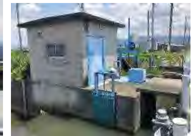
池底まで汲み上げるためのポンプ施設
